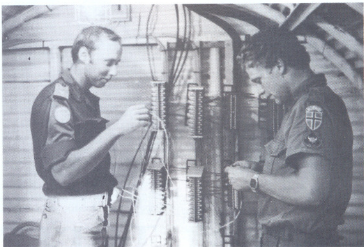
Fra flyttingen av veksleren i midten av september.
